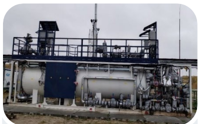
Установки предварительного сброса воды
