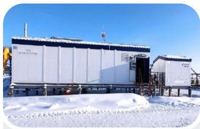
Блоки подготовки газа
